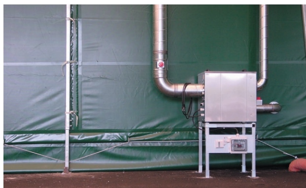
Un déshumidificateur de DST de type Recusorb DR-40 installé dans un hall de stockage en PVC
